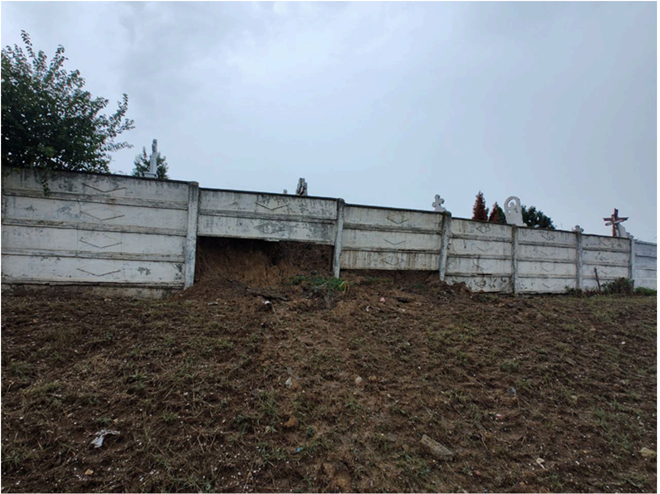
Gardul cimitirului s-a prăbușit
