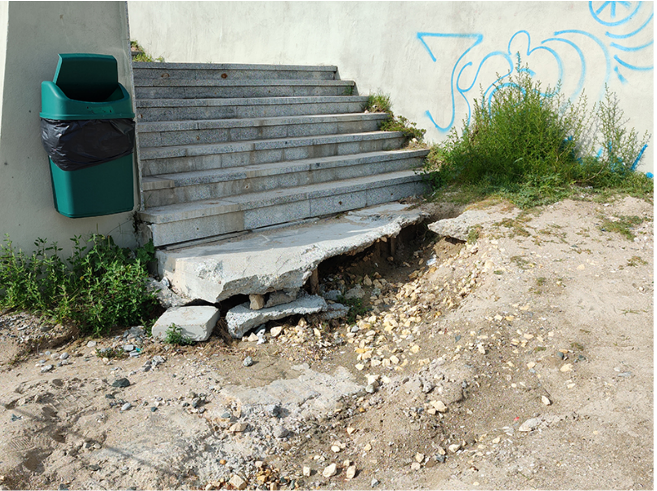
Plaje afectate de inundații
