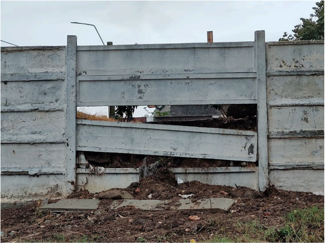
Gardul cimitirului s-a prăbușit
