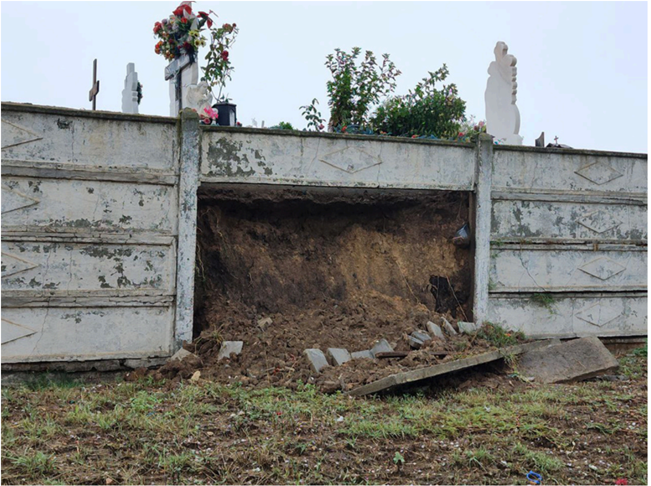
Gardul cimitirului s-a prăbușit
