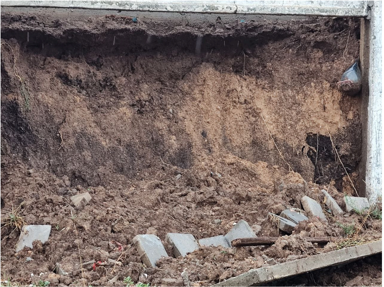
Gardul cimitirului s-a prăbușit
