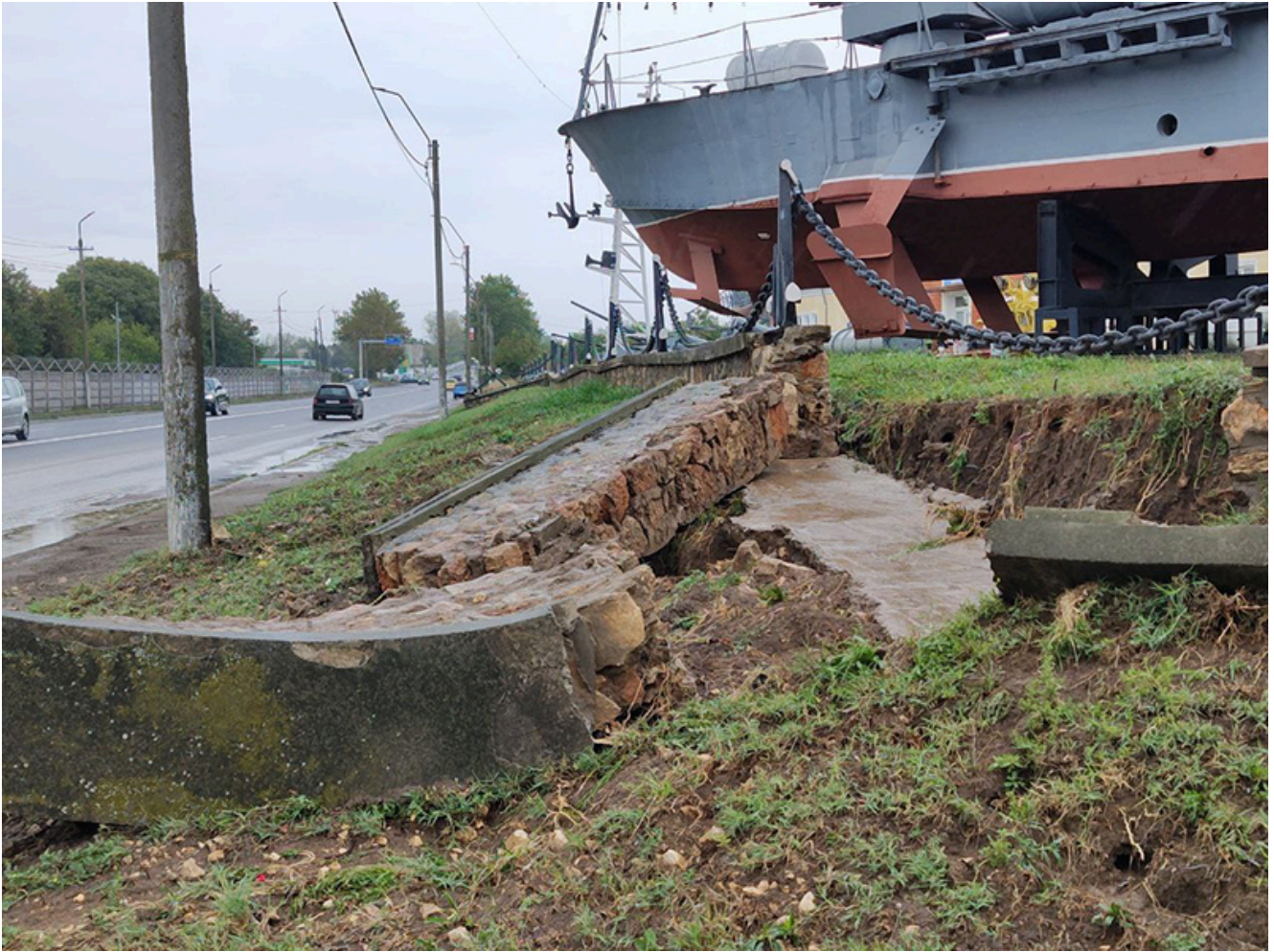
Gardul cimitirului s-a prăbușit
