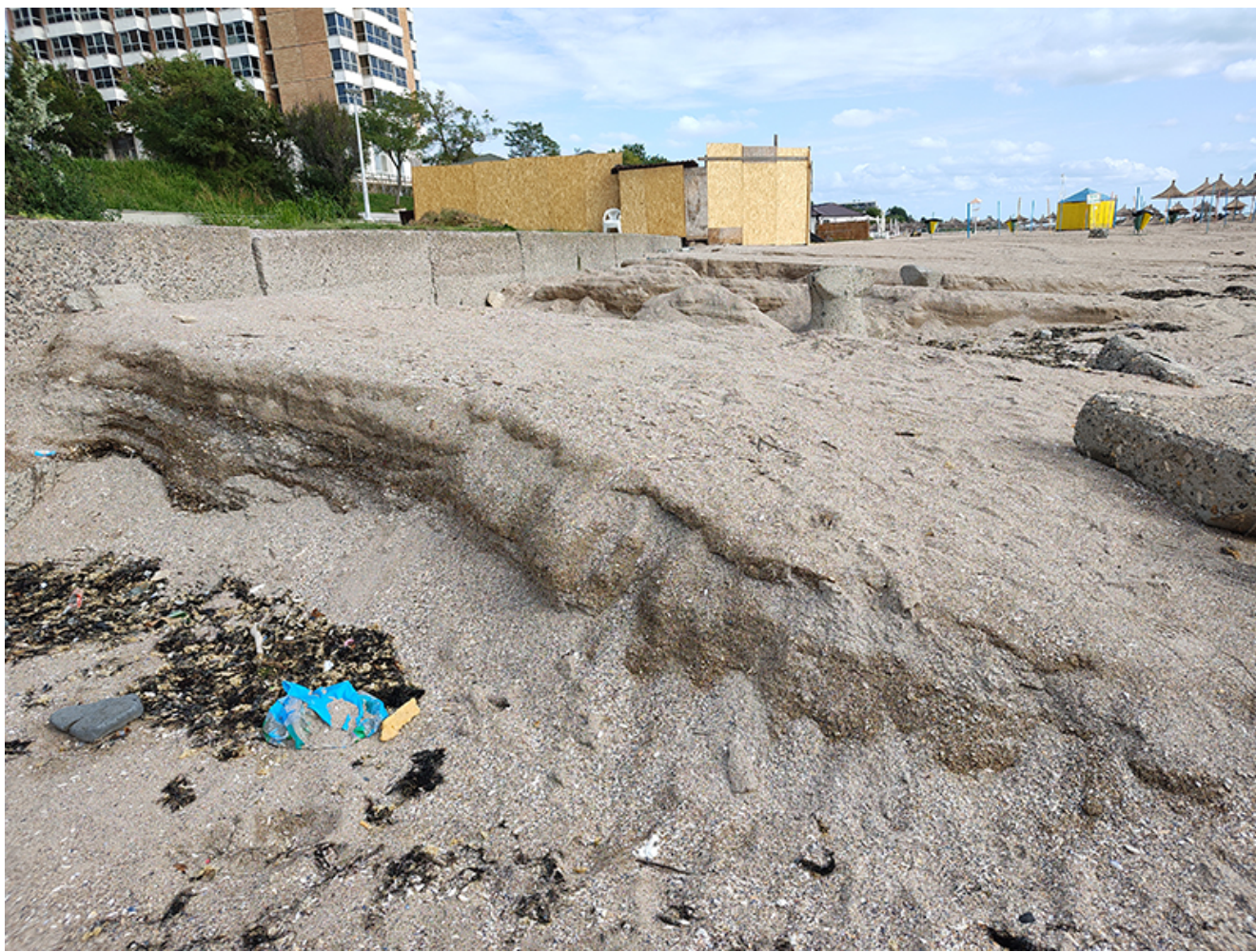
Plaje afectate de inundații
