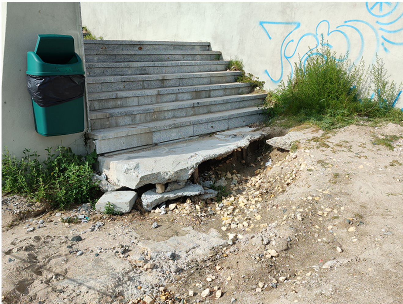
Plaje afectate de inundații
