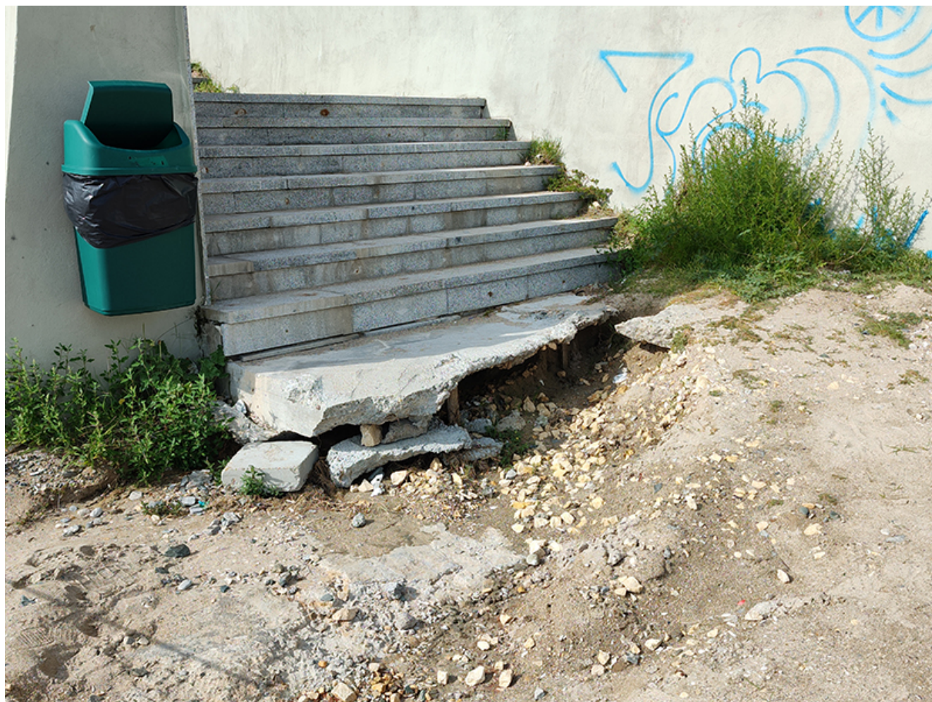
Plaje afectate de inundații
