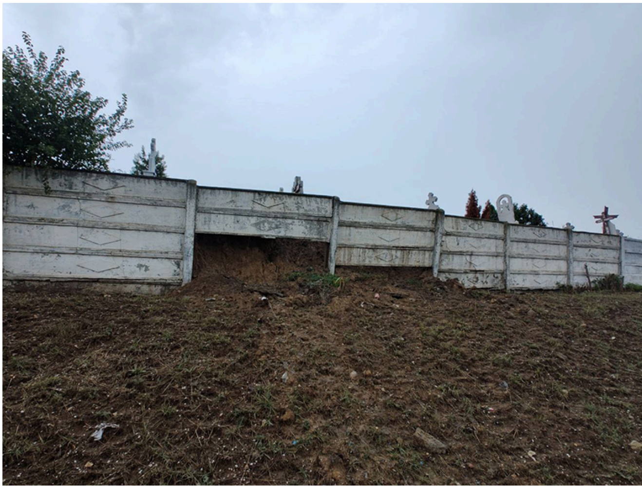
Gardul cimitirului s-a prăbușit
