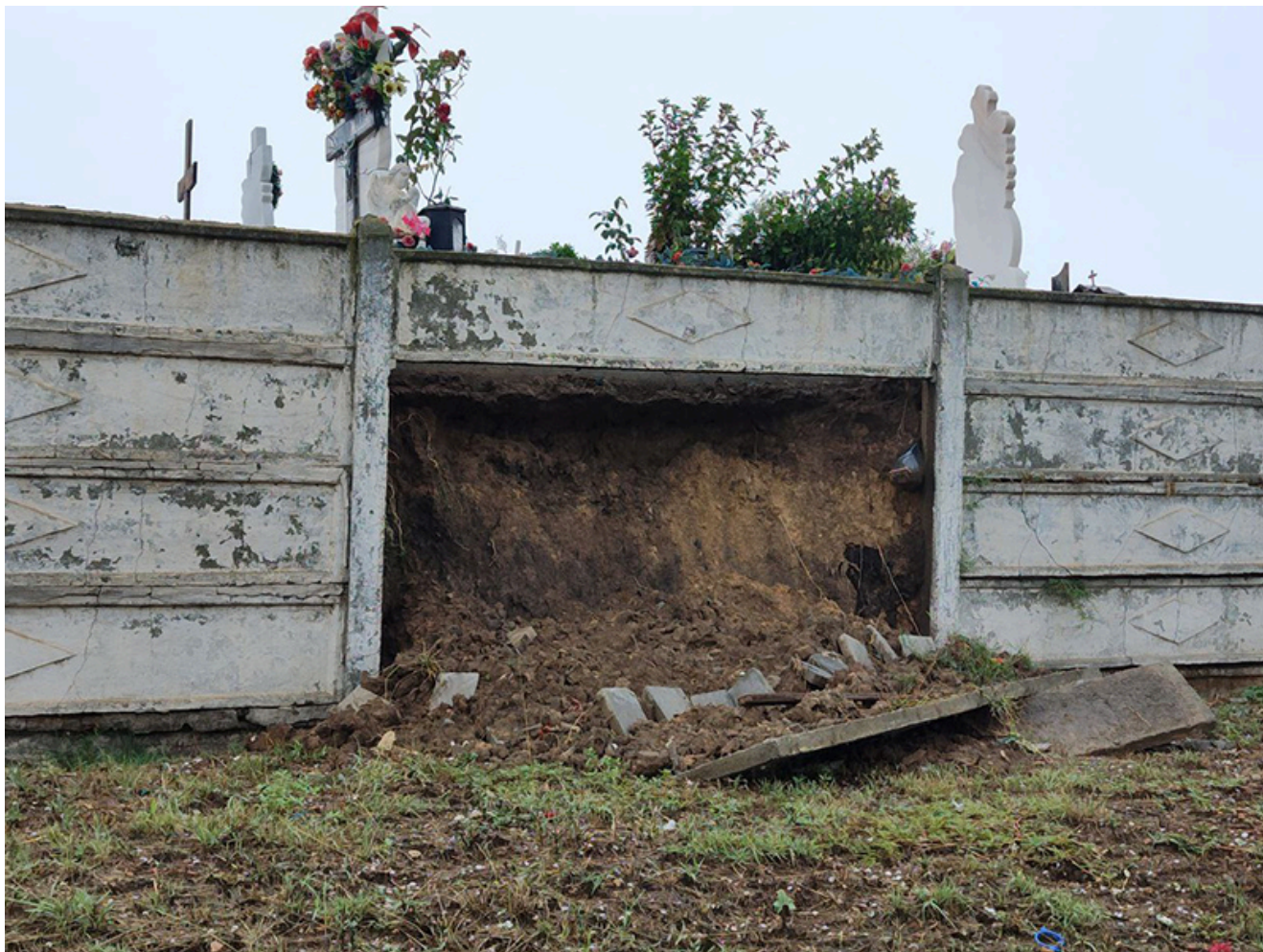
Gardul cimitirului s-a prăbușit
