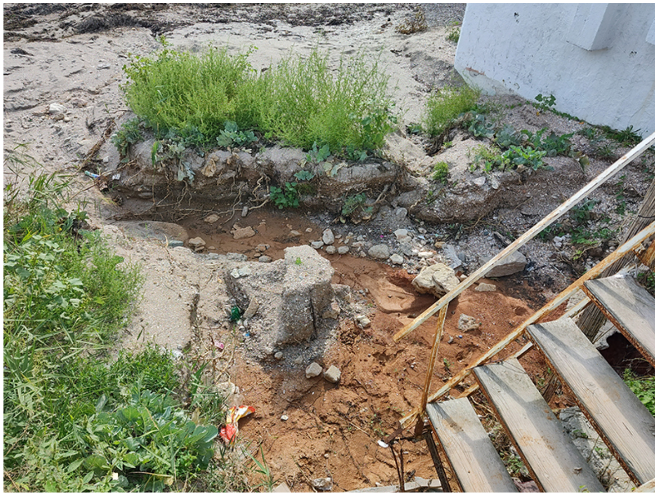
Plaje afectate de inundații
