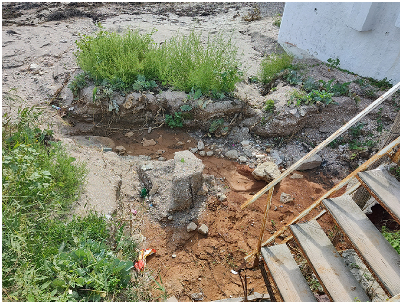
Plaje afectate de inundații
