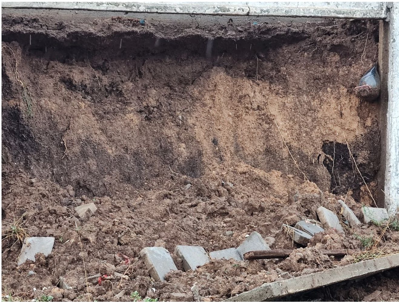
Gardul cimitirului s-a prăbușit
