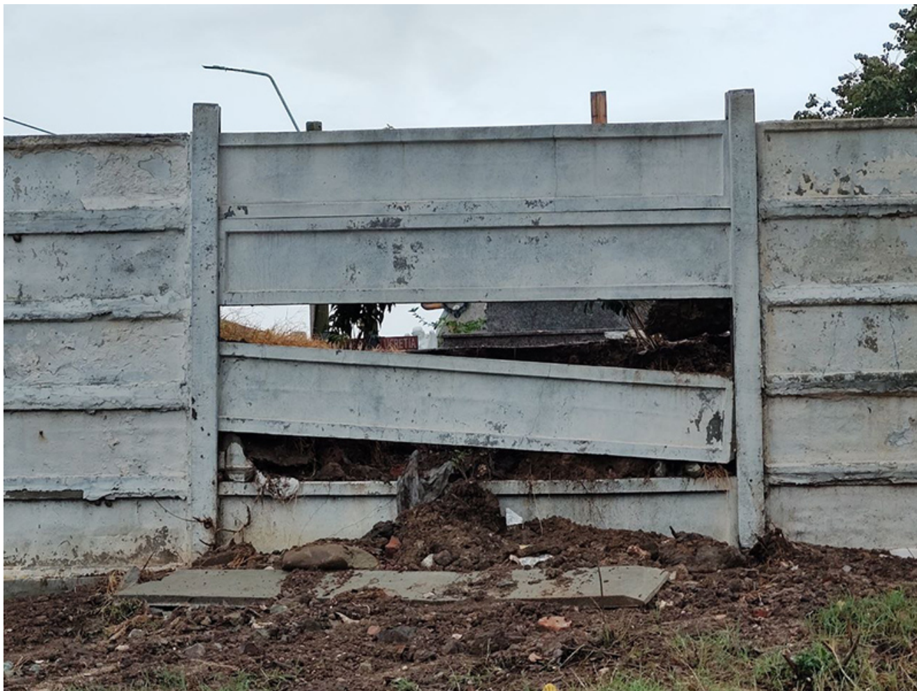
Gardul cimitirului s-a prăbușit
