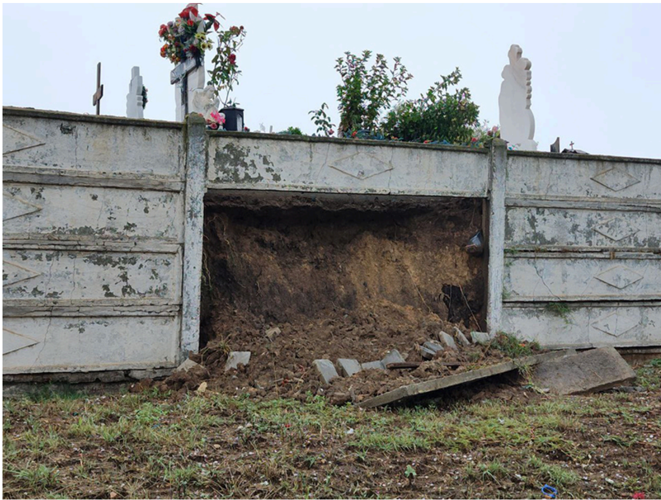
Gardul cimitirului s-a prăbușit
