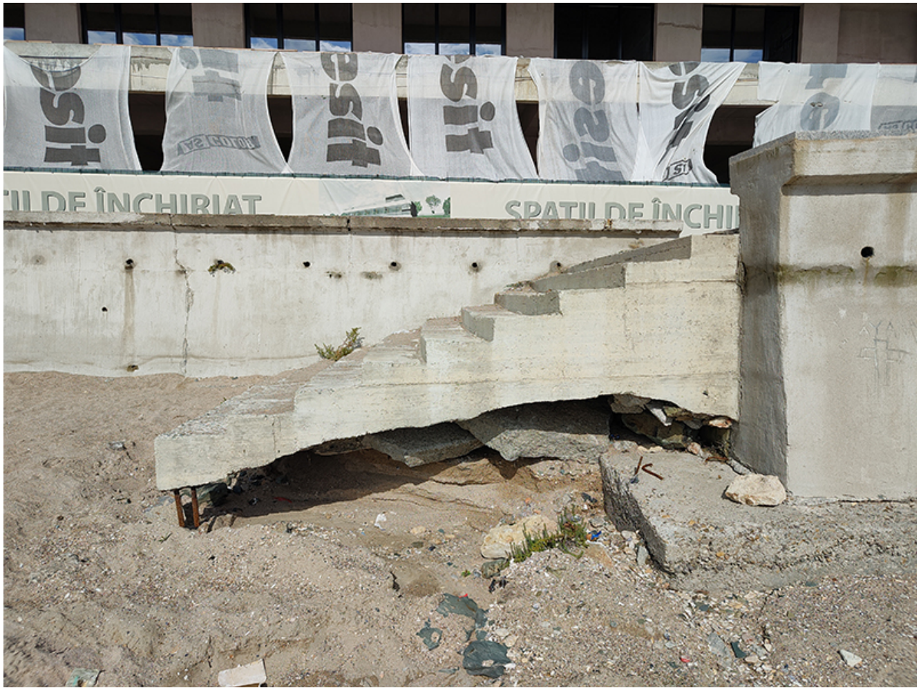
Plaje afectate de inundații
