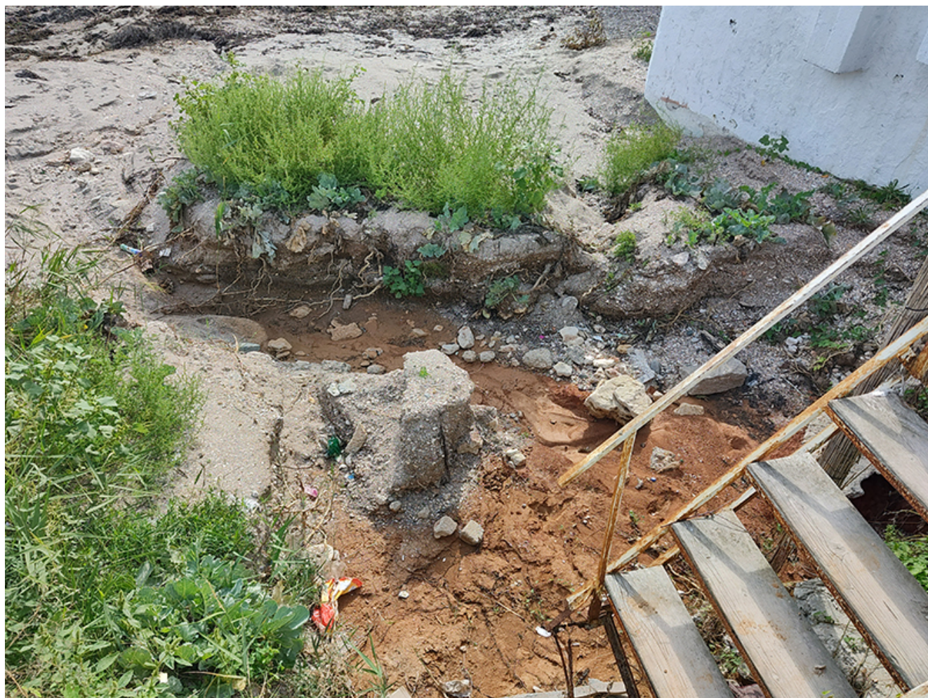
Plaje afectate de inundații
