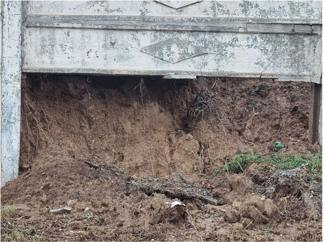
Gardul cimitirului s-a prăbușit
