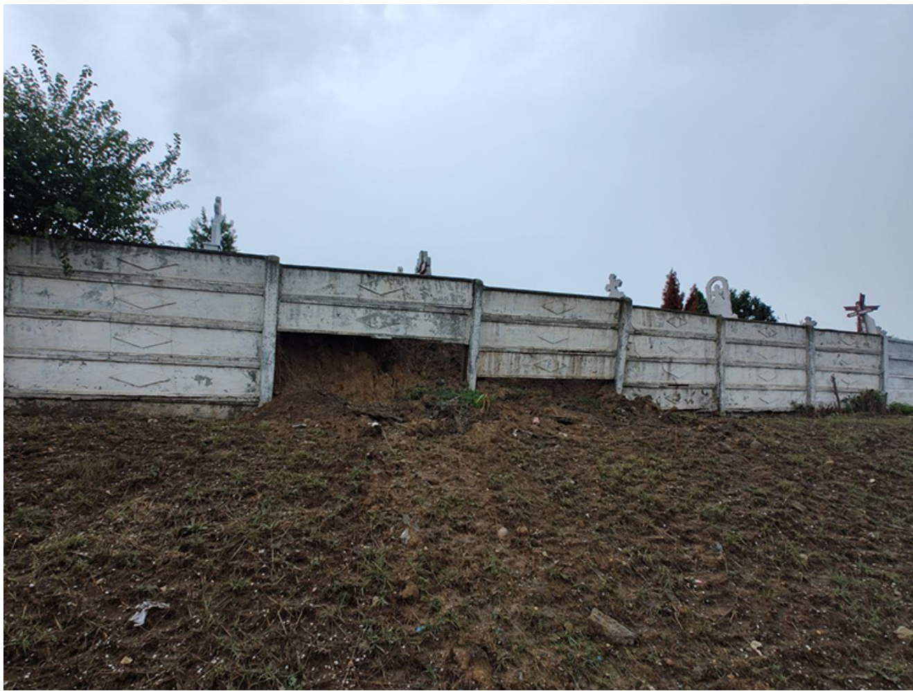
Gardul cimitirului s-a prăbușit
