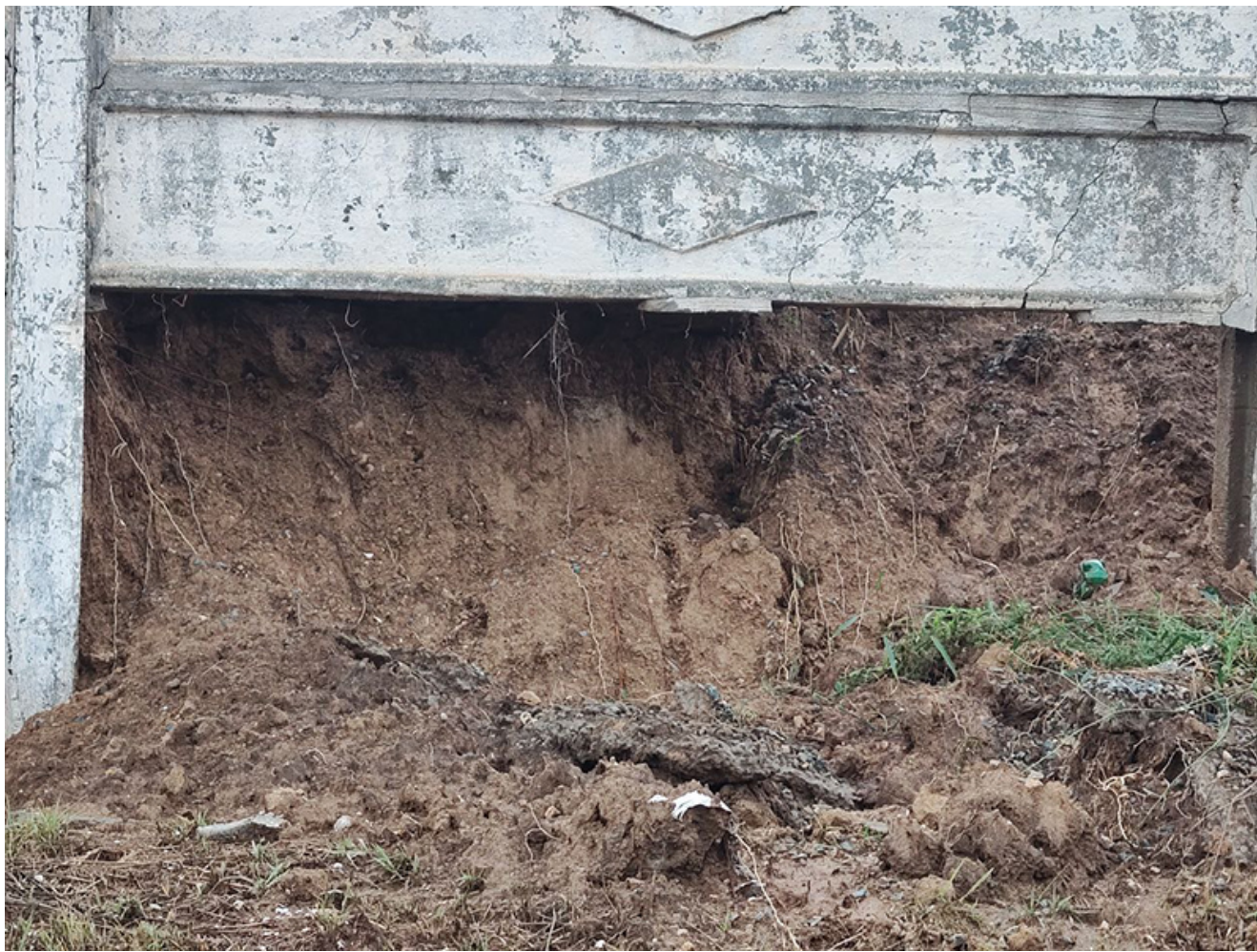
Gardul cimitirului s-a prăbușit
