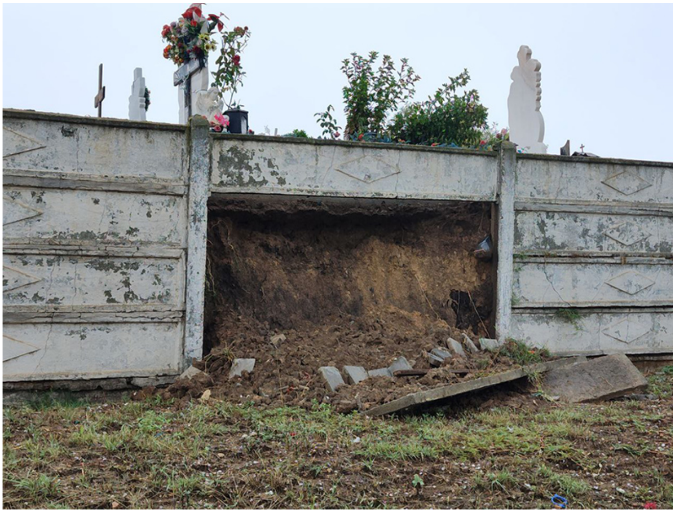
Gardul cimitirului s-a prăbușit
