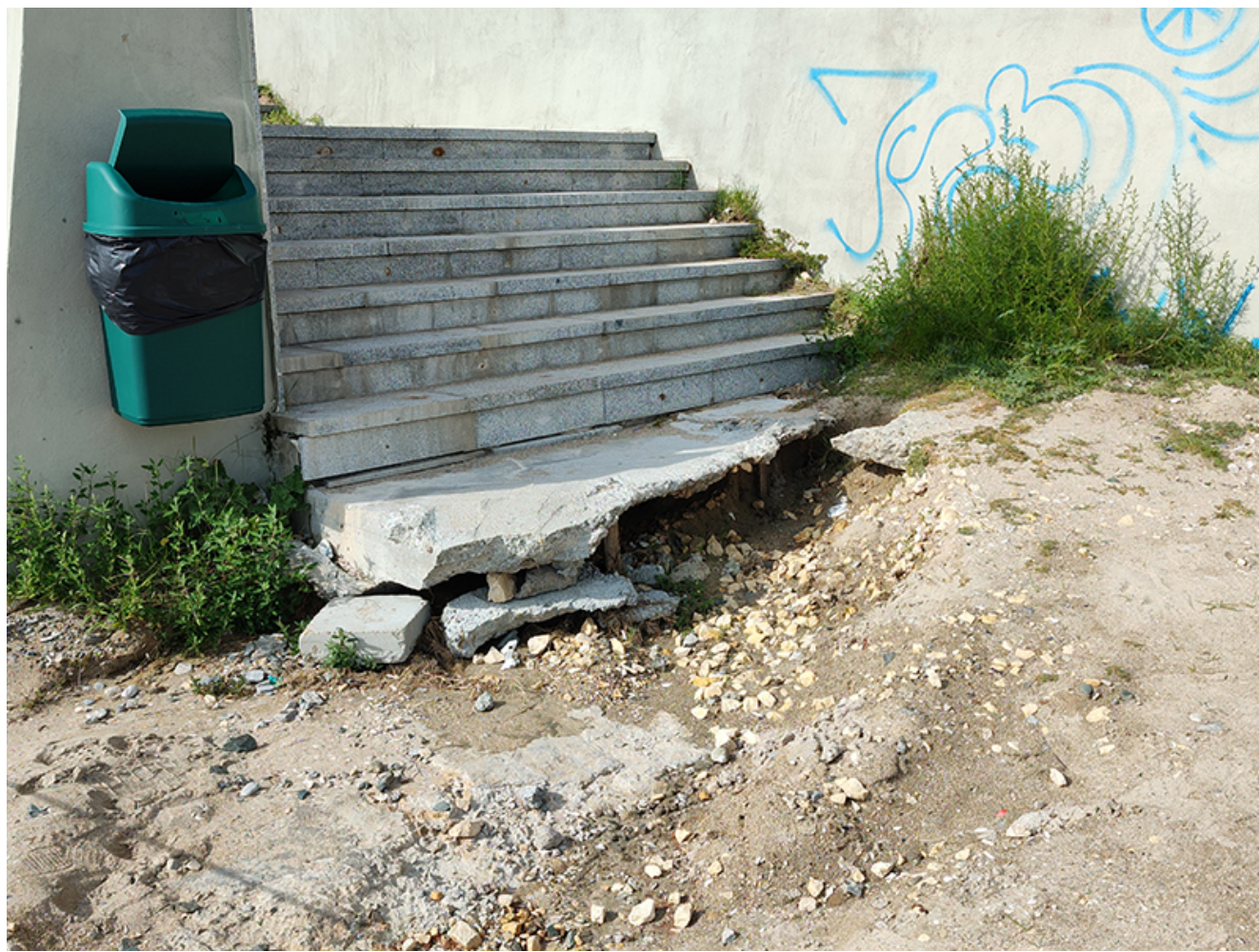
Plaje afectate de inundații
