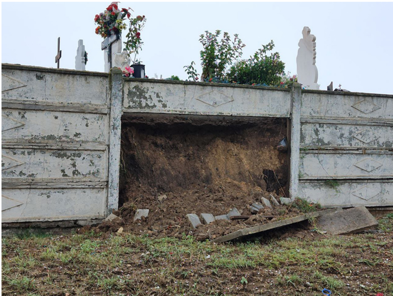
Gardul cimitirului s-a prăbușit
