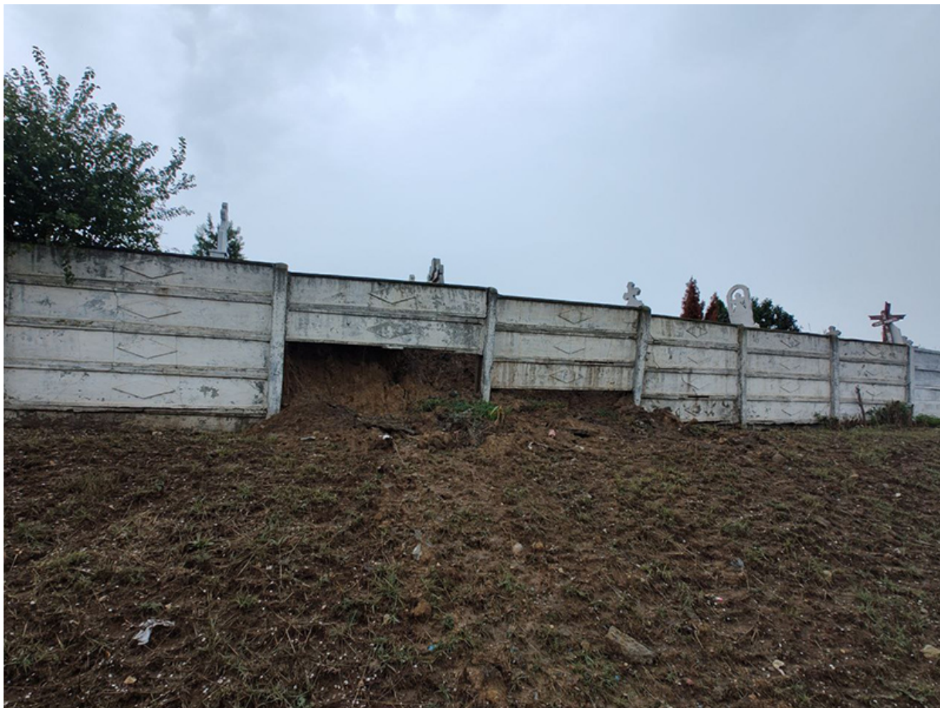
Gardul cimitirului s-a prăbușit
