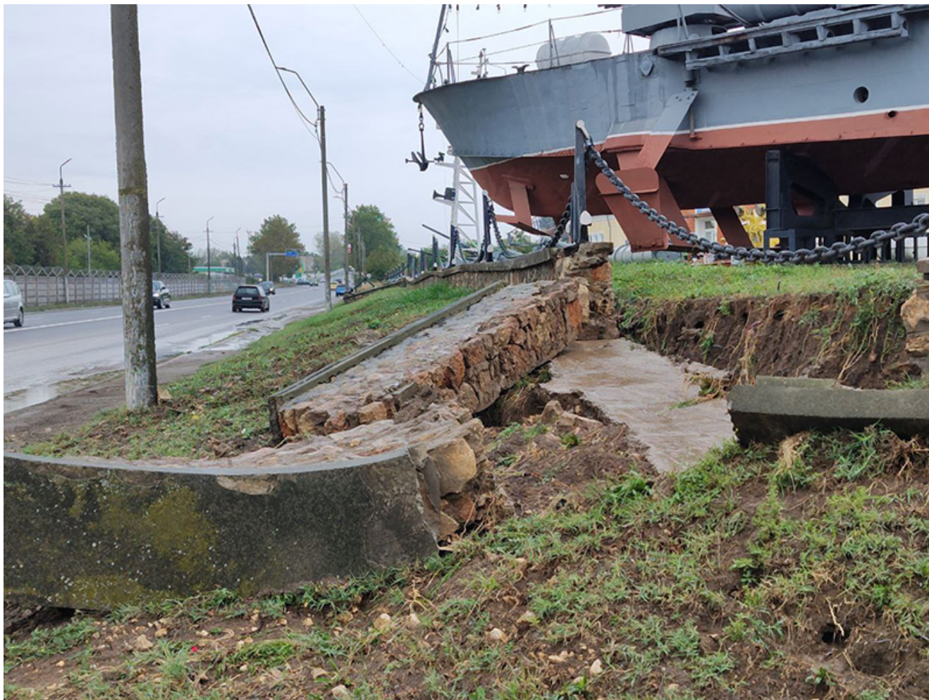
Gardul cimitirului s-a prăbușit
