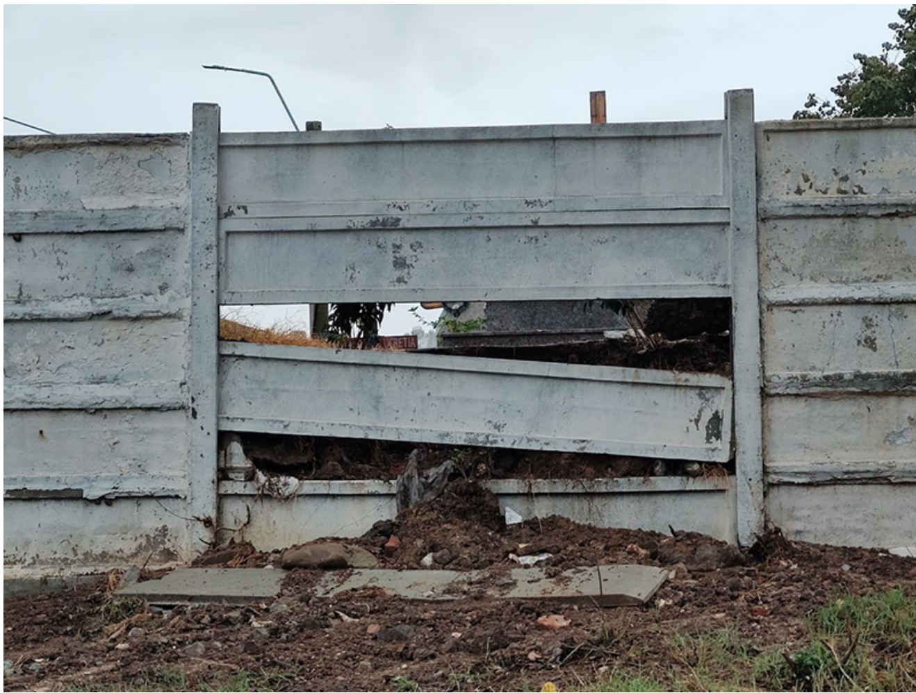
Gardul cimitirului s-a prăbușit
