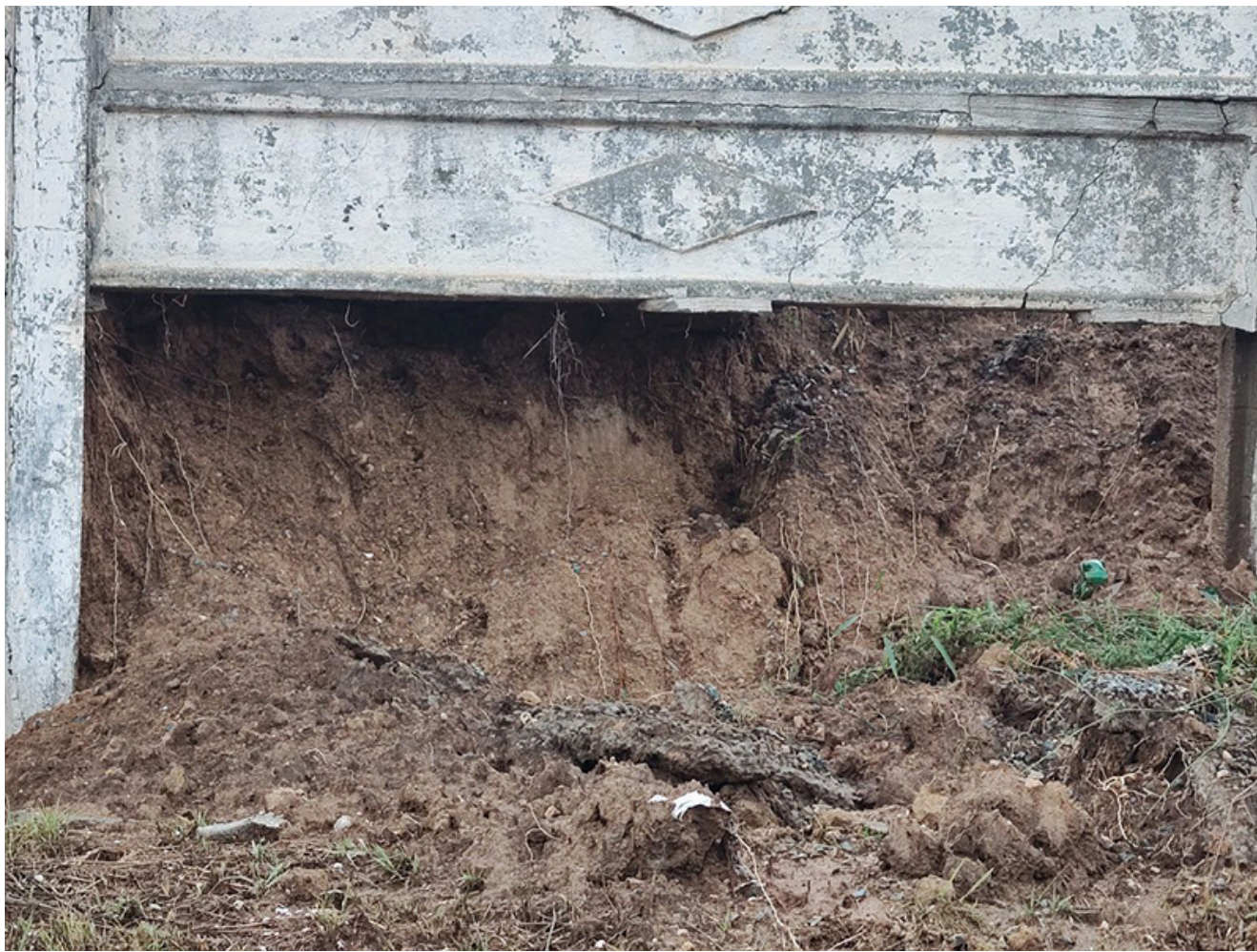
Gardul cimitirului s-a prăbușit
