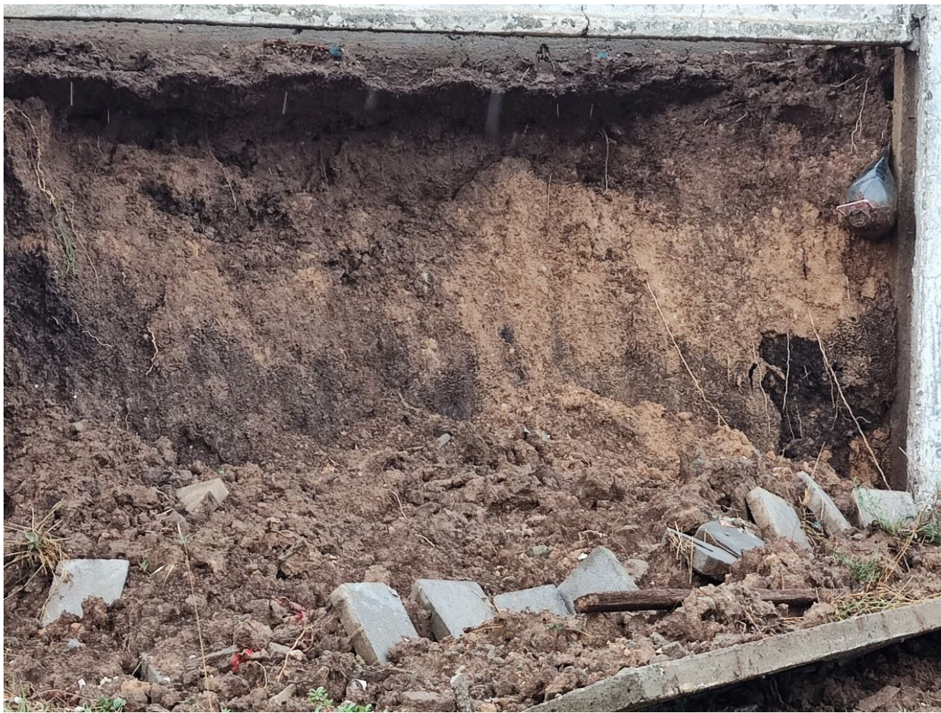
Gardul cimitirului s-a prăbușit
