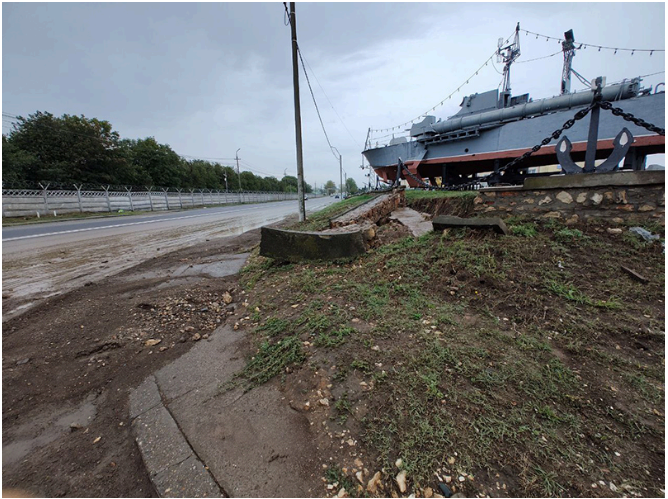
Gardul cimitirului s-a prăbușit
