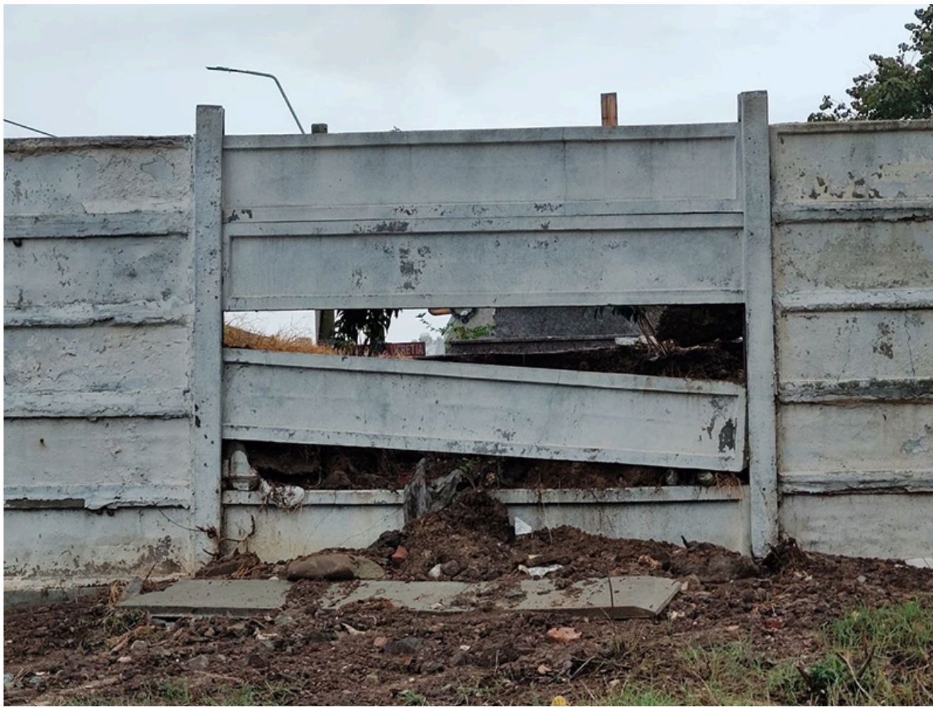
Gardul cimitirului s-a prăbușit
