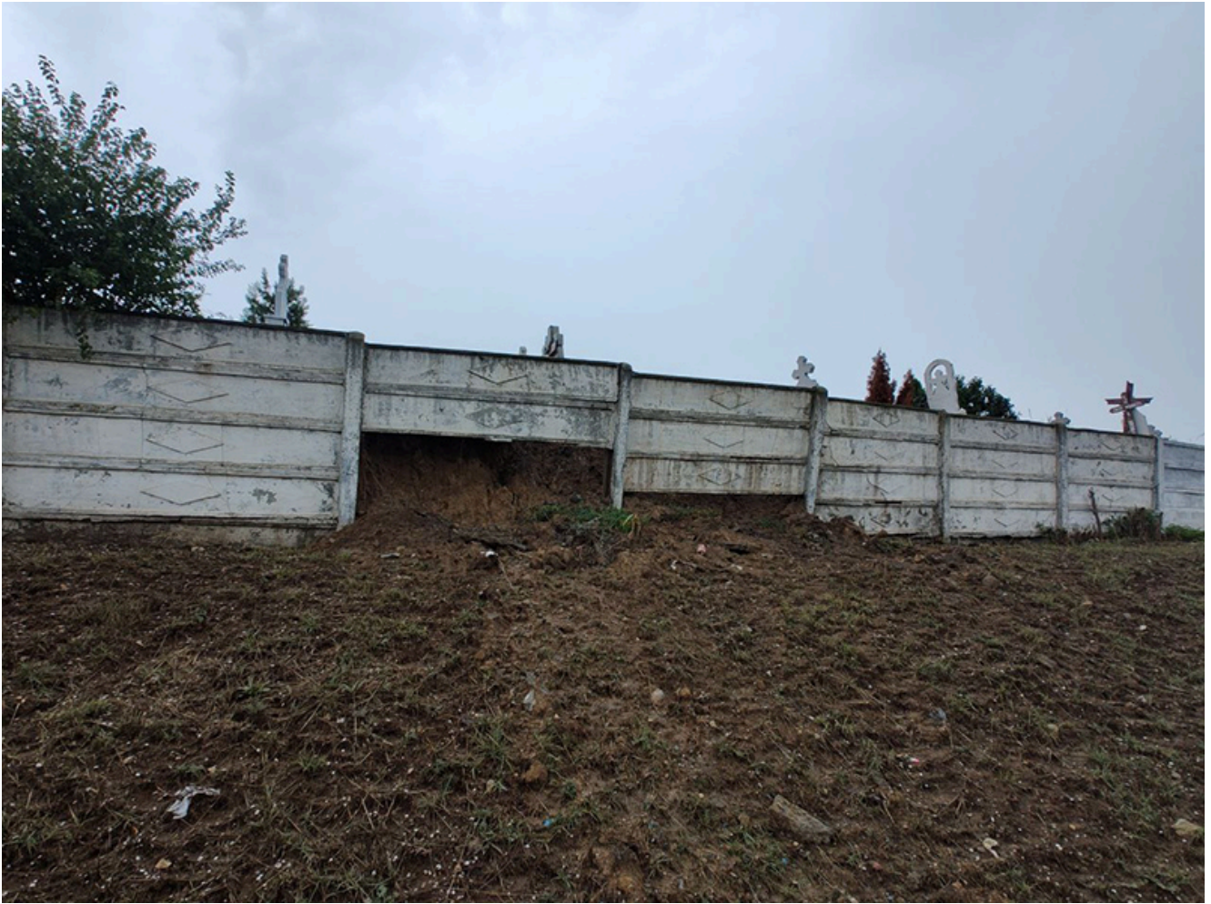
Gardul cimitirului s-a prăbușit
