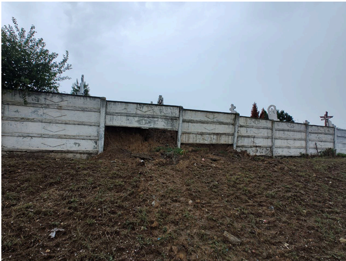
Gardul cimitirului s-a prăbușit
