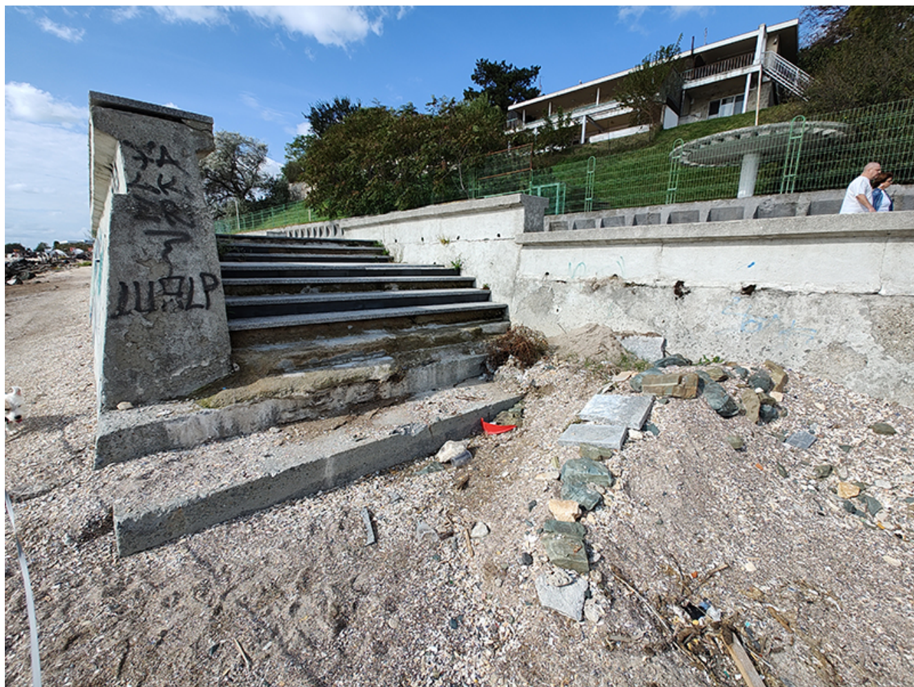
Plaje afectate de inundații
