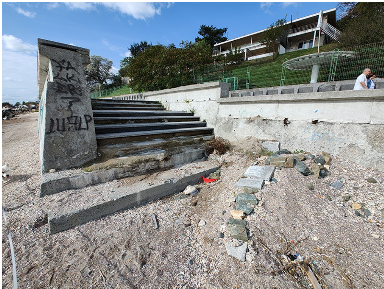
Plaje afectate de inundații
